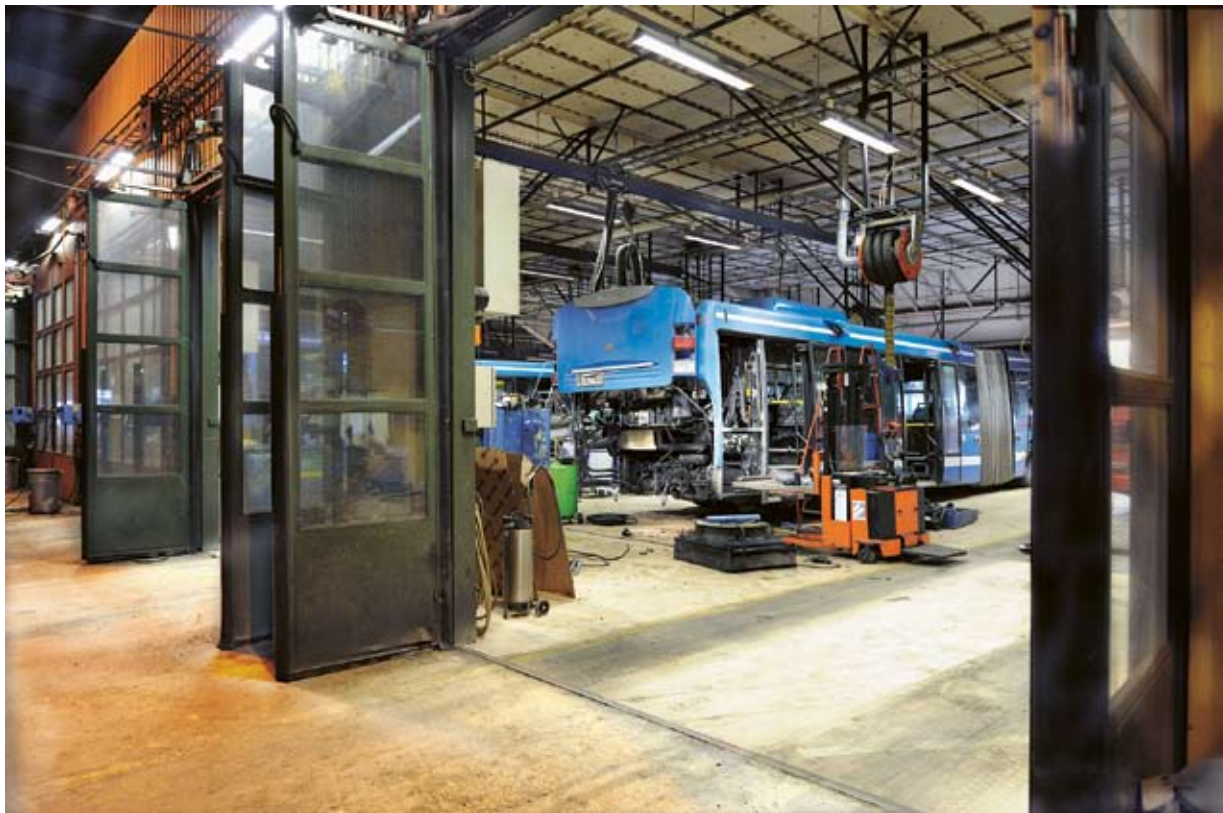
Verkstad 2 i det norra garaget där reparationsarbeten på en ledbuss pågår. Foto Tomasz Pydzik 2009. SSM DIG 002024.
