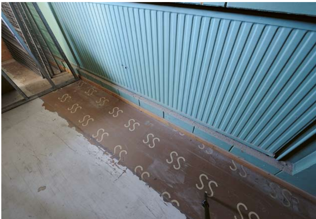
Detalj av golvet i samlingsalen med Stockholms Spårvägars emblem, bokstäverna SS. Foto Tomasz Pydzik 2009. SSM DIG 002051.
