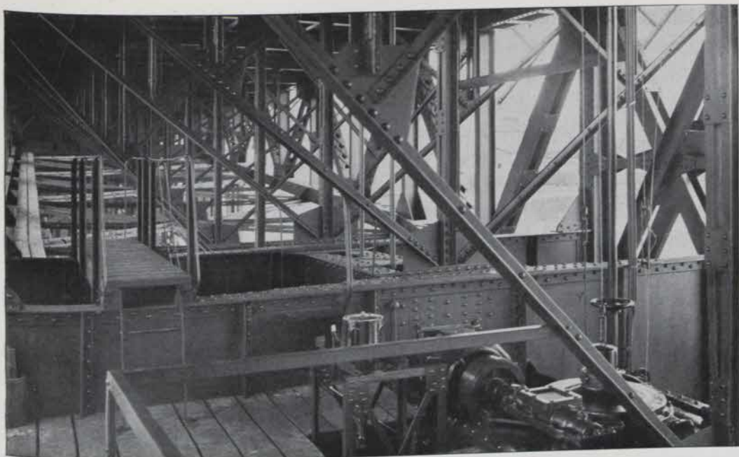
SVÄNGSPANNETS BÄRSTRUKTUR SAMT VRIDNINGSMASKINERI.
