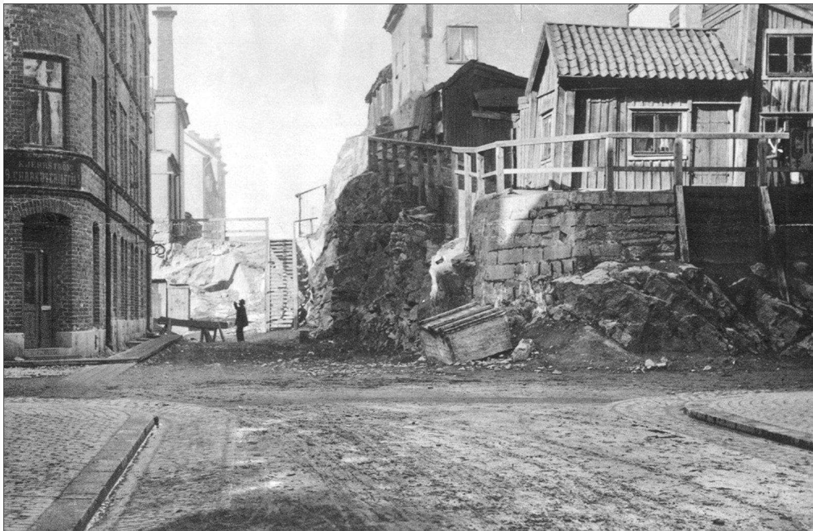
Jungfrugatan mot norr. Fotografen står strax nedanför Tyskbagargatan. På klinten till höger Ständdrabantens hus, i dag Jungfrugatan 40 med Hedvig Eleonoragården som byggdes 1926–27. Huset till vänster finns än i dag. När bilden togs, troligen 1890, var det tämligen nybyggt och hade ännu inte reveterats. Sträckningen av Östermalmsgatan mellan Sibyllegatan och Jungfrugatan blev klar först omkring 1903 och byggnationen kunde sätta igång. SSM.
