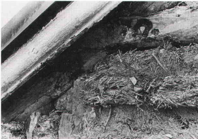
Detalj vid taklisten. Man ser en nummerad takstol och den gjutna stommen av lera och halm. Puts och horisontala granslanor är borttagna. Foto Göran Fredriksson, 1986. SSM.
