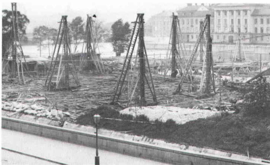
Pålning för riksbankshuset på västra delen av holmen. I bakgrunden Bondeska palatset vid Drottninggatan. Foto 1897.
