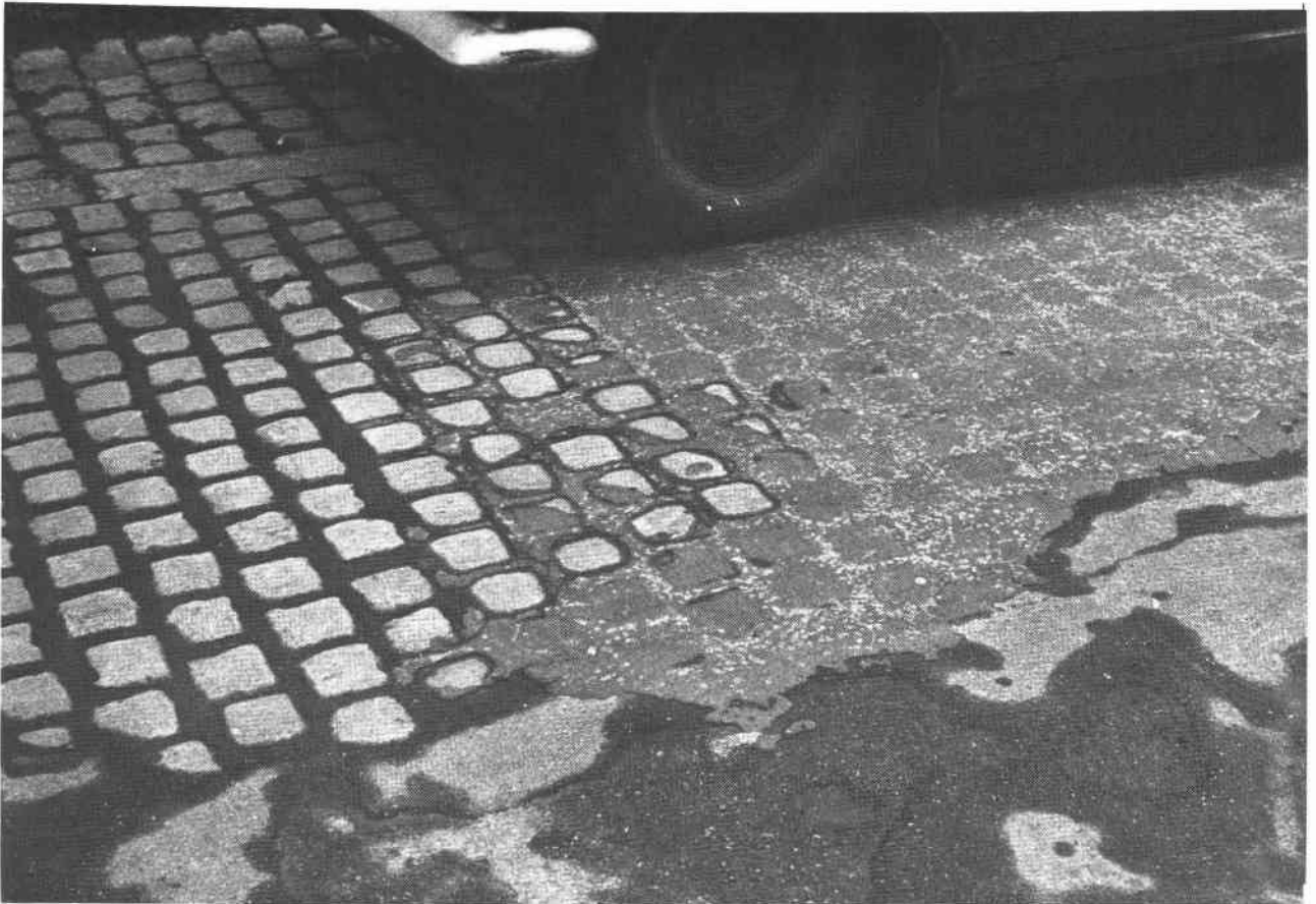
Bild 41. Kvarngatan. Exempel på underhåll av gatuytor genom asfaltbe- läggning på äldre stenbeläggning.
