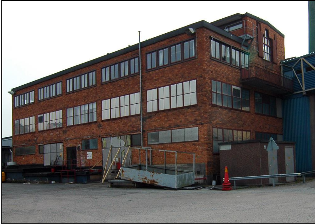
Nitrolackfabriken maj 2008. Funktionalismen har nått Lövholmen. Horisontella fönsterband i liv med fasaden, ett signum för funkisfabriken. Ventilationstrummor, telferbalk och skärmtak är borttagna. Evakueringsröret på den västra sidan är inbyggd med plåt. (Foto: Jonas Vikström)
