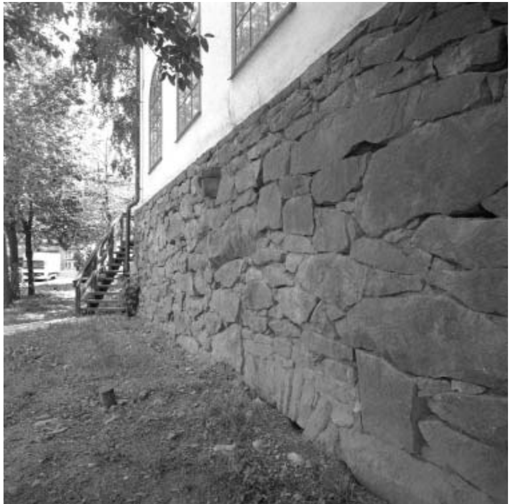
Söder Mälarstrand 17. Den murade, höga sockeln med igensatt muröppning vid dagens marknivå. IJ S2004-0095-01
