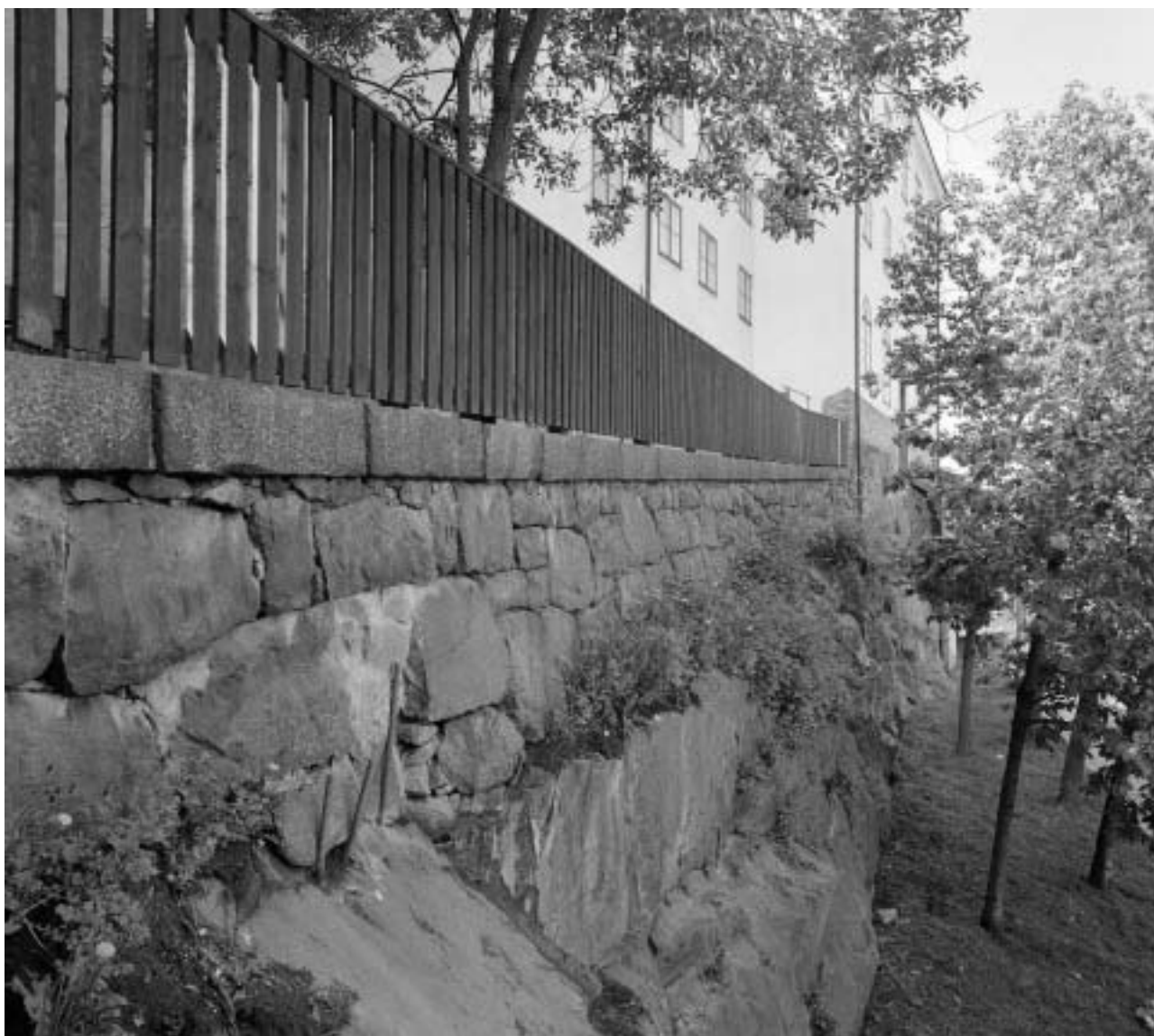
Även den nedre gården vid Söder Mälarstrand 17 är uppförd med murverk av gråsten direkt på berget. Till vänster relativt moderna bultar. IJ S2004-0091-9
