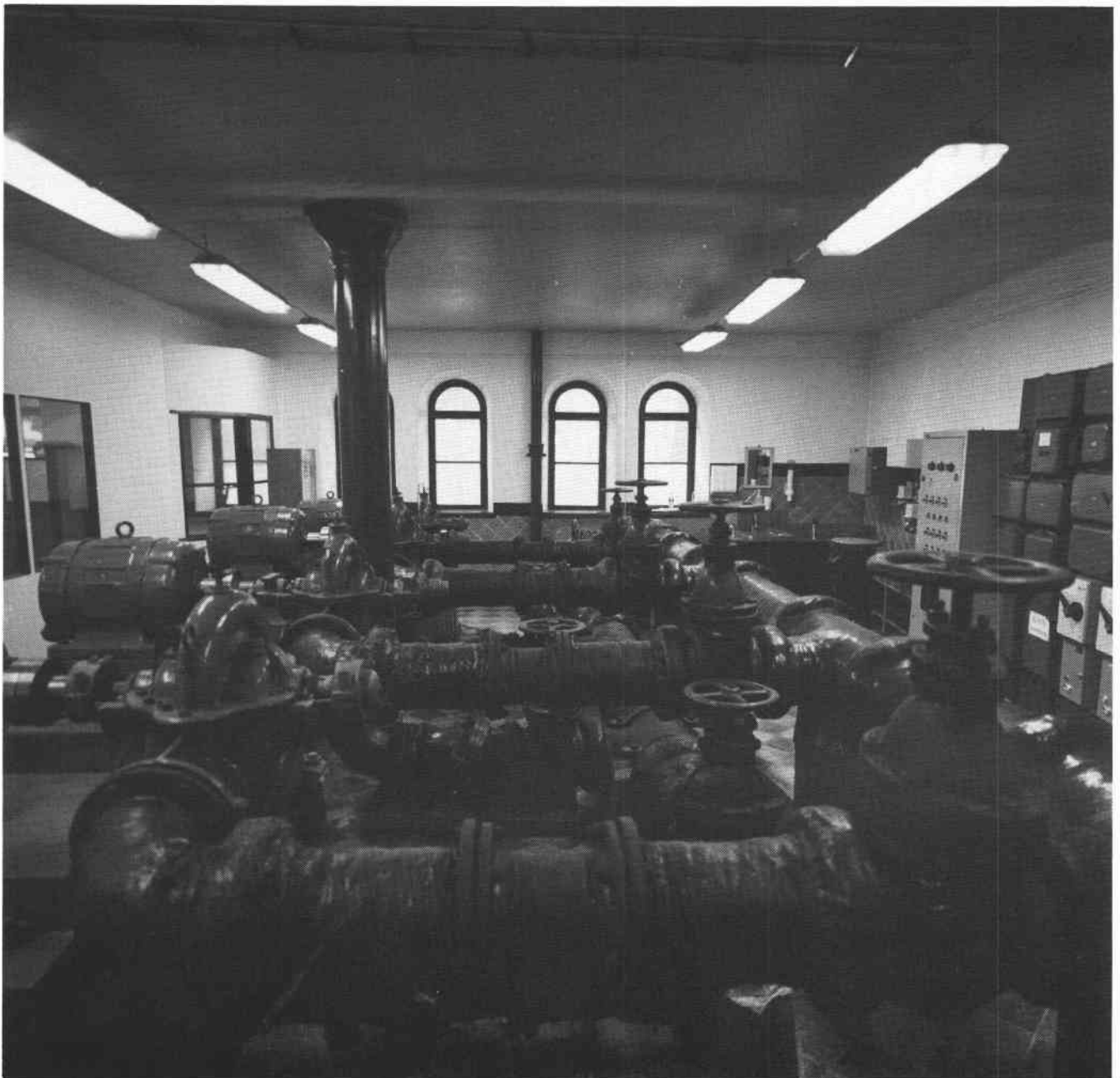
Pumphusets fyra aggregat. S82-0317-2.
